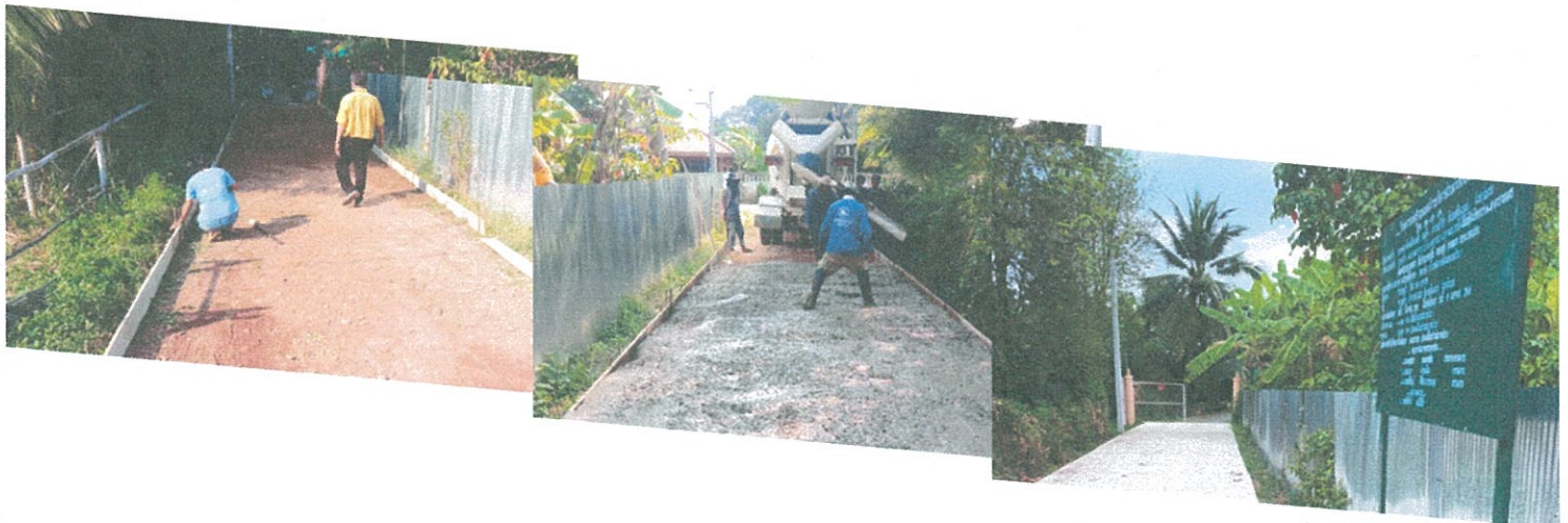
โครงการก่อสร้างถนน คสล. ม.4 ต.น้ำชำ ตั้งแต่ส่วนนางจรรยา ถึงบ้านนายทัศน คลองสุข
